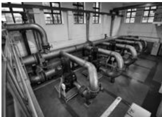
il. 10 Infrastruktura pompowni III o na terenie SW1 po ostatniej modernizacji z lat 2002–2010, widok współczesny (źródło: Muzeum Wodociągów w Bydgoszczy, fot. Marek Chelminiak)
