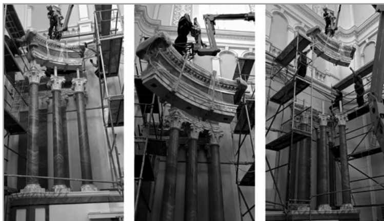
il. 8. Kościół Najświętszego Zbawiciela w Warszawie, wznoszenie ołtarza Miłosierdzia Bożego – montaż belkowania na kolumnach ramion ołtarza, fot. Tomasz Olszewski, 2023
